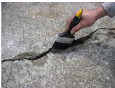
② 施工部分のゴミやホコリ、軟弱部分を取り除きます。
