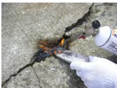
④ QSバーを加熱し、やわらかくなったら、施工部分にヘラ・コテ等で押し込みます。
